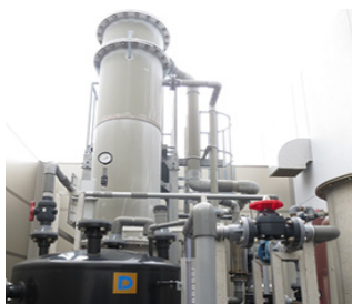
本社事業所の地下水浄化装置
