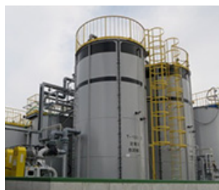
豊岡工場の廃水処理設備
