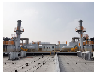
杭州ヤマハのVOC処理施設
