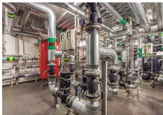
Sistema de calefacción urbana
