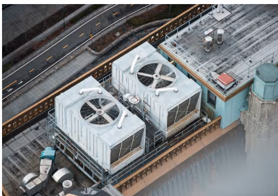
HVAC o Aire acondicionado
