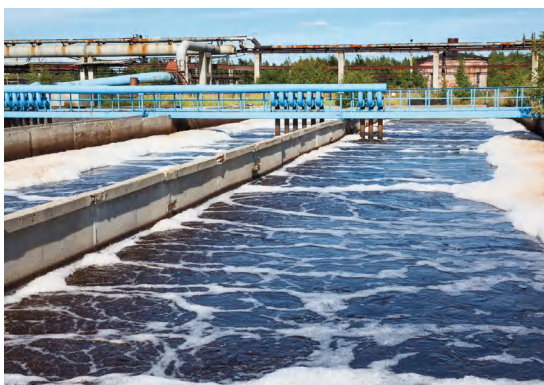
Tratamiento de aguas residuales
