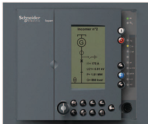
Controllo locale dall'UMI sinottica.
