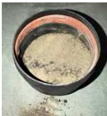
Beispiel eines verschmutzten Deckels
