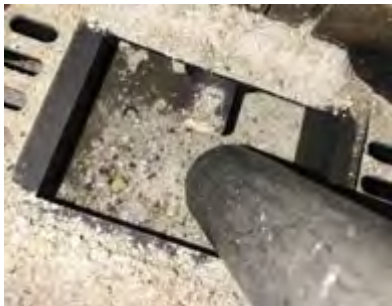
Beispiel eines verschmutzten Bodens
