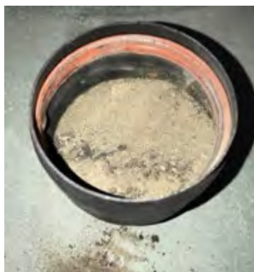
Beispiel eines verschmutzten Deckels
