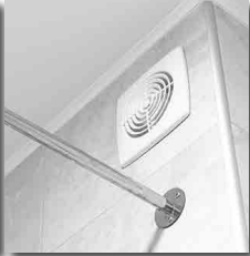
Bathroom fan control
