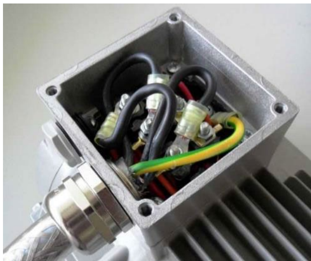
Fig. 23: Cablaggio nella cassetta di connessione motore
