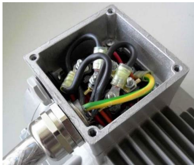
Fig. 27: Cablaggio nella cassetta di connessione motore
