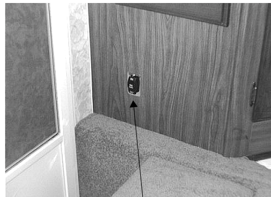
Aux. Battery Switch
