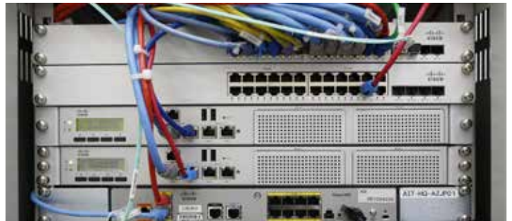
外部ネットワークとの接続に高性能ファイアウォール MX400 (下 段) を利用。 L3スイッチ MS350-48 を通じて工場内にネットワークを分岐 (上段)
