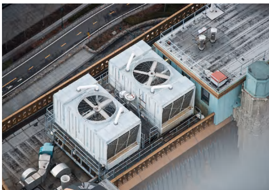
HVAC e Ar Condicionado
