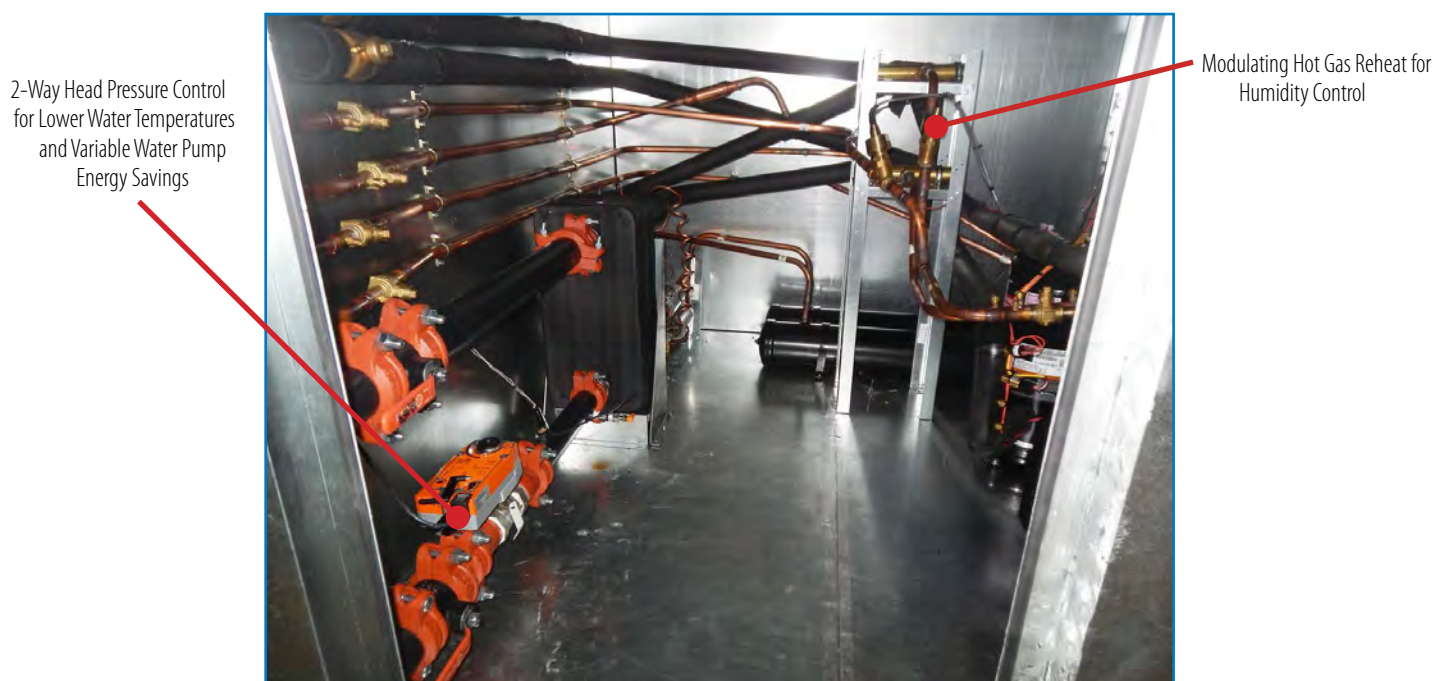
30 ton WSHP Module Interior
