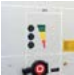
Sinalização de pressão SF6
