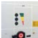
Sinalização de pressão SF6
