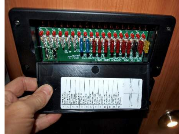
12 volt DC fuse box
