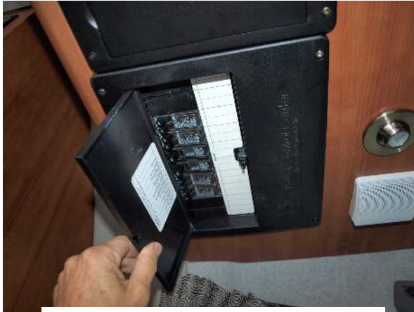
120 volt AC distribution center
