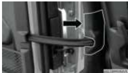
Wiring Access Door
