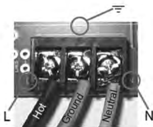
Power Module Wiring
