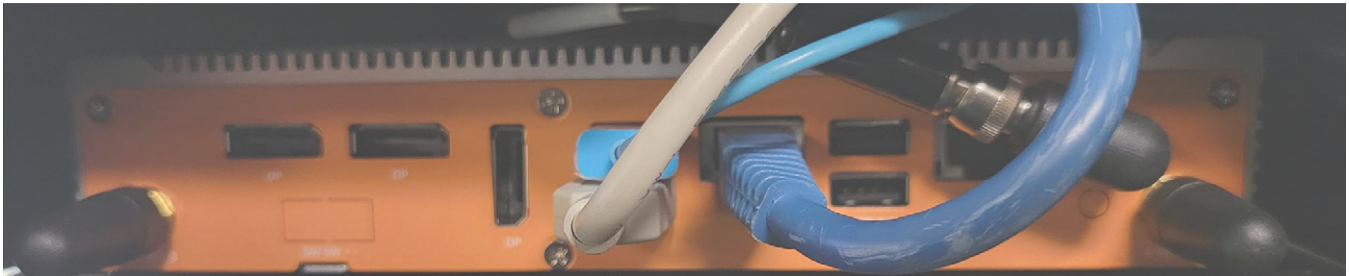
Figura 9. Cables conectados y adaptador de alimentación
