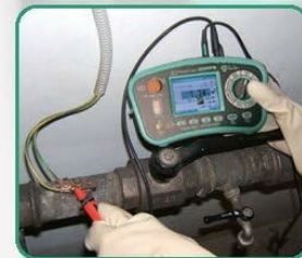
Continuity check of equipotential bonding
