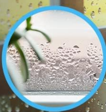
Condensation sur les fenêtres
