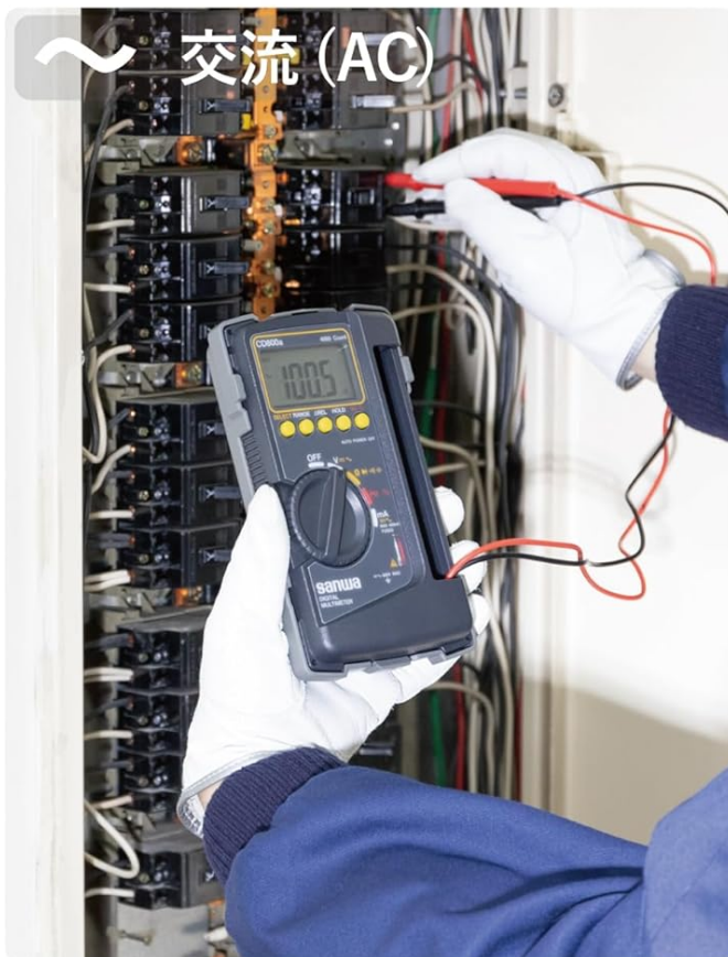
ビルや工場の電気設備 (AC100V・200V)
